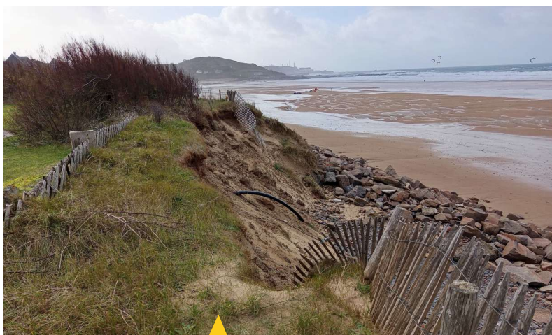
Les dégâts liés à la tempête et la houle des 6 et 7 décembre derniers.
